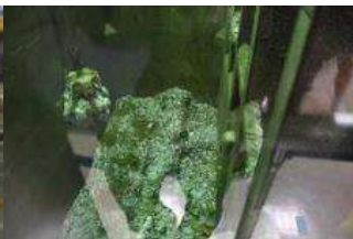
焼却ごみを掴み上げるごみクレーン
