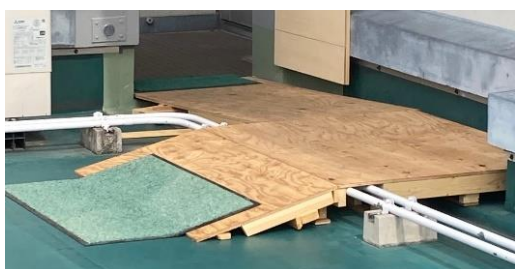
※3階バルコニーへ続く入り口の段差がスロープ状に改善されていました。
