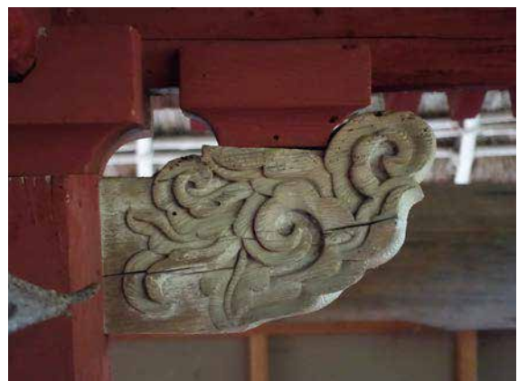
本殿庇の頭貫木鼻
