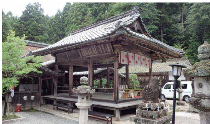
修理前の様子
