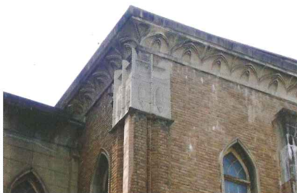
指定 府立医科大学旧附属図書館 軒回り (京都市上京区)
