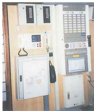
本法寺自動火災報知設備（上京区）
