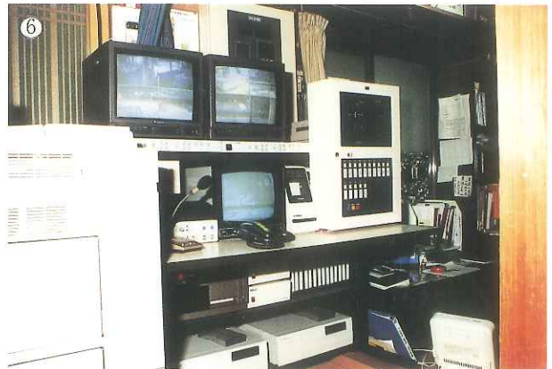
籠神社自火報・防犯設備
