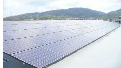
【南校舎屋上の太陽光パネル】
